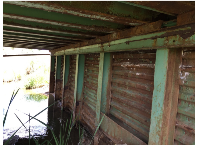
Antes de las reparaciones, 2017
